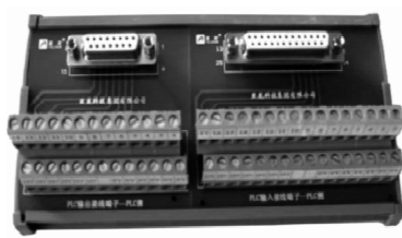
图 1-11 PLC 侧的接线端口
